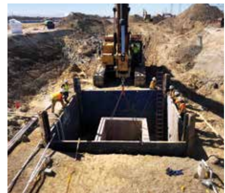
South Lathrop Commons, California, EUA Pozo/Estación de bombeo • Bio-San C500, Megamix II con Bio-San
